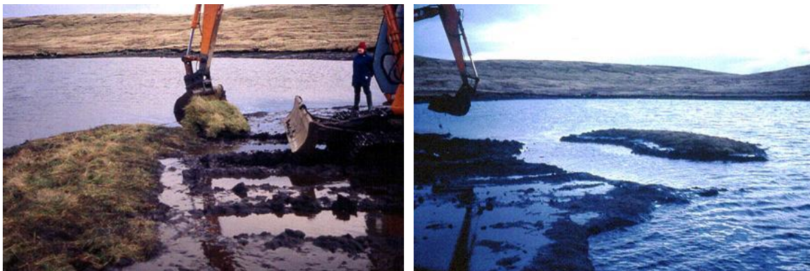
Genom att schakta bort landmassor skapas en häckningsö för smålom. Åtgärden har testats i Skottland med lyckat resultat. Foto: David Okill
